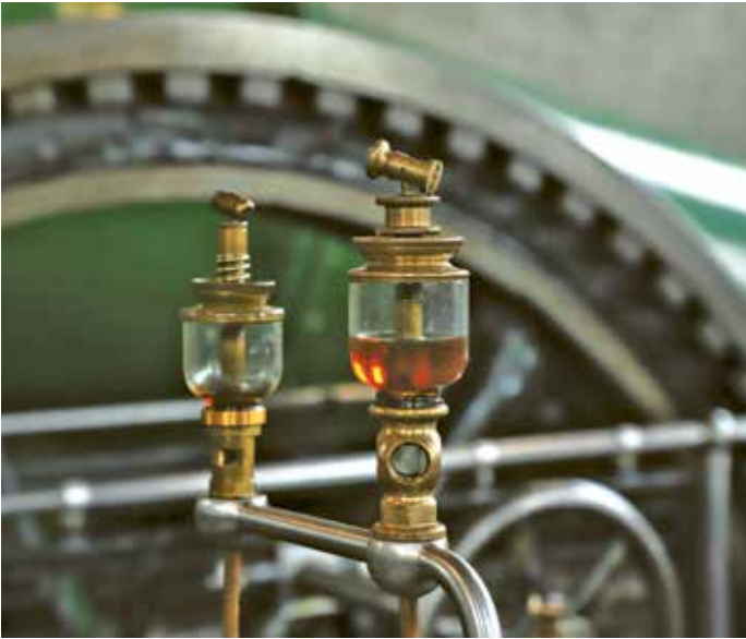
Stoomgemaal De Tuut in Appeltern: museale waarde Ooit waren er in het rivierengebied 34 stoomgemalen verantwoordelijk voor het droog houden van de polders. Hoe dit werkte is nog te zien in museumstoomgemaal De Tuut uit 1918. Het is een bijzonder gaaf gebleven rijksmonumentaal complex met ketelhuis en machineruimte, een kolenloods en dubbele dienstwoning. De schoorsteen in 1997 herbouwd. De waterafvoerende functie is in 1967 vervangen door het nabij gelegen gemaal Bloemers.
