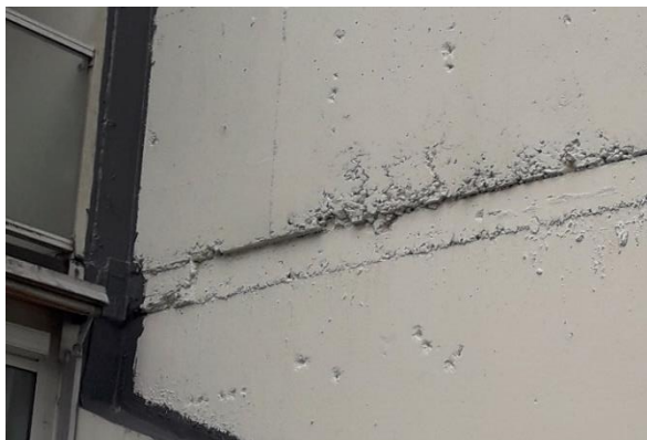
Figuur 12: Kopgevel met stortsporen en grindnesten.
