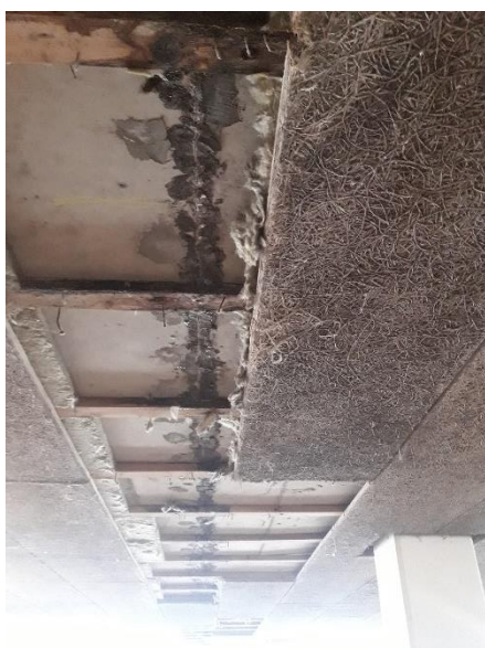
Figuur 55: Scheuren in de betonnen dekvloer zijn zichtbaar waar de plafondafwerking verwijderd is. Hierdoor sijpelt vocht doorheen. Er zijn diverse pogingen gedaan voor waterdichting.
