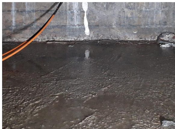
Figuur 87: Bodem van de kruipruimte onder de woning. Er is zicht op ruw beton zonder waterkerende laag.
