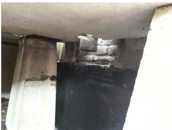
Figuur 113: Hemelwaterafvoerbuizen ten behoeve van het dak van een woningblok. Hier wordt het regenwater geloosd in de kruipruimte, waarna het verder wordt afgevoerd naar de straatkolk.
