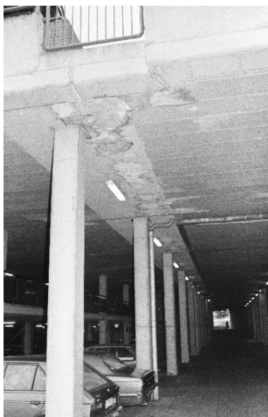
Figuur 84: Foto van de parkeerplaats in 1983. Er zijn vochtplekken aan de onderzijde van het beton zichtbaar. De foto is genomen dicht bij de entree aan de Vossenstraat, voordat de wijzigingen aan de entree zijn aangebracht.
