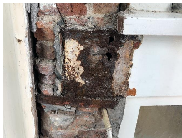
Figuur 124: Geoxideerde stalen ligger bij de oplegging; in de flens van de UNP is een gat ontstaan.
