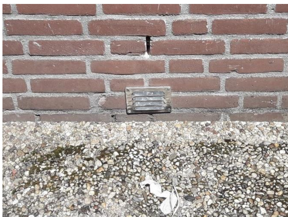
Figuur 108: Rooster in de gevel van de woning, ten behoeve van extra ventilatie van de kruipruimte onder de woning.
