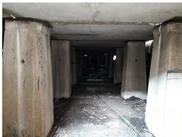
Figuur 65: Zicht in de kruipruimte onder de straat. Tussen allerlei kieren komt licht door waar water ook doorheen kan.
