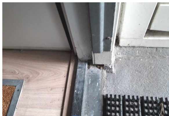
Figuur 106: Dorpel van de voordeur met rechts de cementlaag waarop de waterdichte coating is aangebracht. Tussen de dorpel en de cementlaag is geen voeg aanwezig.
