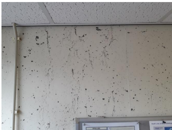
Figuur 10: Binnenzijde van het in het werk gestorte beton op de begane grond, met luchtbellen en stortsporen.
