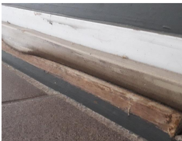
Figuur 32: Aansluiting van het kozijn op de vloer aan de binnenzijde. De houten lat is zichtbaar; het kunststof randprofiel is aanwezig, maar sluit niet aan op de vloer. Hier is geen waterdichte en tocht dichte aansluiting gewaarborgd.
