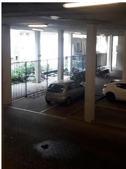
Figuur 51: Het druppelen van water in de parkeergarage. Vochtplekken op het plafond en op de vloer zijn zichtbaar.
