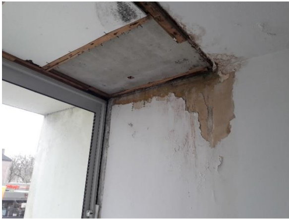
Figuur 4: Onderzijde van het balkon aan de westgevel met vlekken door waterinsijpeling en schimmelvorming. De naisolatie is deels verwijderd.
