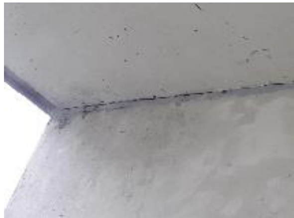
Figuur 7: Naden tussen balkon en kopgevel aan de zuidoostgevel met mosgroei tussen de naad. De naad was recent opnieuw gekit.
