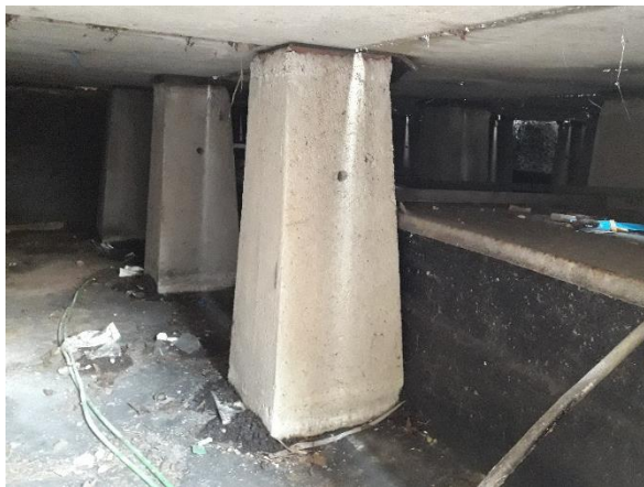
Figuur 74: Poeren voor de grindtegels onder de straat. De poeren zijn direct op de waterdichte laag geplaatst, zonder onderzetter.
