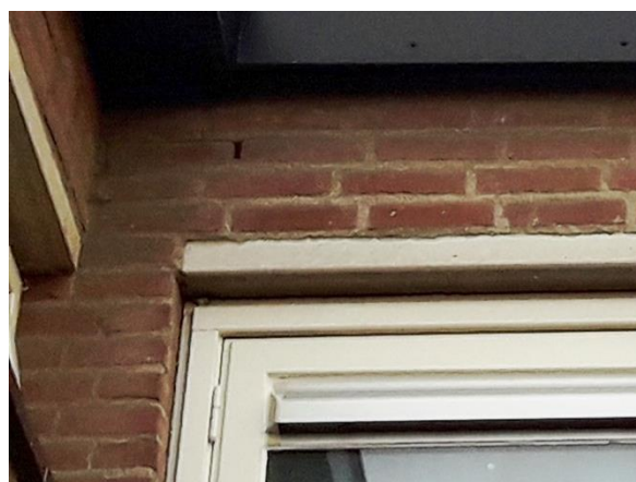
Figuur 94: Kozijn waar geen waterkering in de vorm van een asfalt bitumen viltstrook zichtbaar is. De kozijnen zijn nog origineel, niet de draaiende delen.
