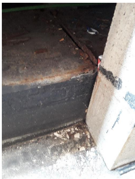
Figuur 76: Leidingkoker met muren van metselwerk en afgedekt met een metalen afdekplaat. Tegen het metselwerk is bitumen zichtbaar en de metalen afdekplaat vertoont beginnende roestvorming.
