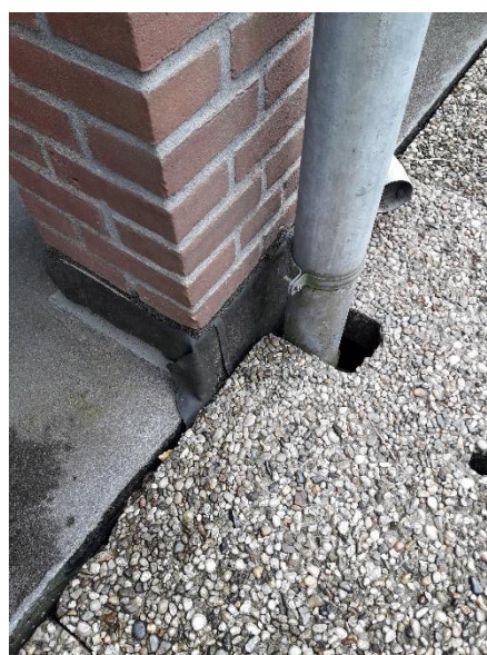
Figuur 67: Openingen zijn gelaten tussen het gebouw, de betonvloer van de nissen van de entrees en de hemelwaterafvoer. Hierdoor kan water naar de kruipruimte lopen.
