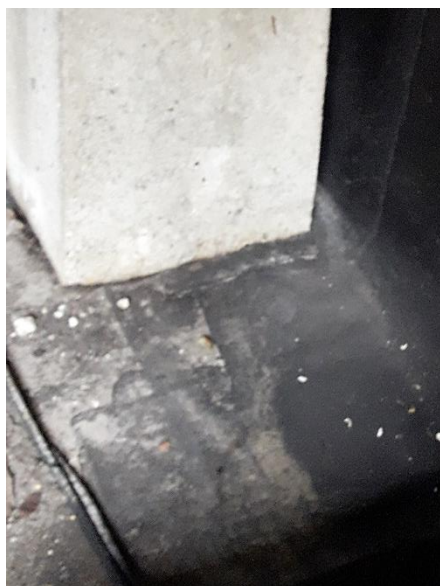
Figuur 71: Bitumineuze dakbedekking met diverse plakaten over elkaar aangebracht.
