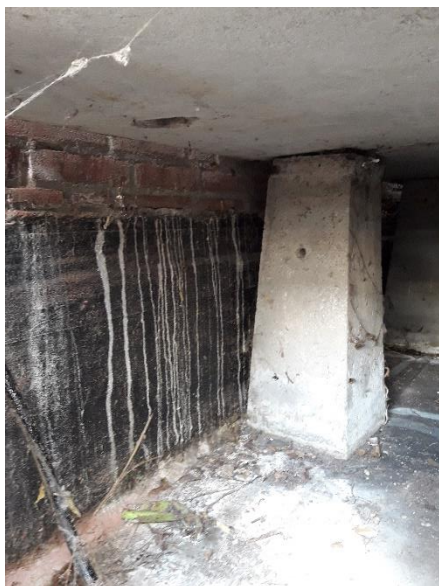
Figuur 79: Bitumenrand tegen de ringbalk van een woningblok in de kruipruimte onder de straat.
