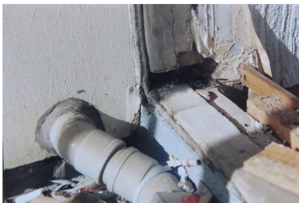
Figuur 23: Aansluiting tussen de balkonafdeling en het balkon, gefotografeerd in. Er is nog geen afdichtingsstrip aangebracht. Ook zijn geen sporen zichtbaar die duiden op eerdere plaatsing.
