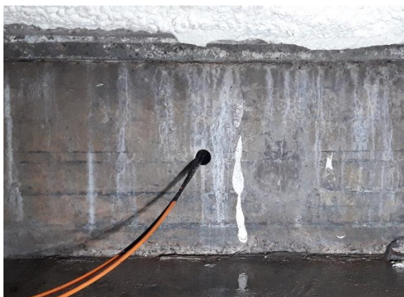
Figuur 90: Vanuit de kruipruimte onder de woningen is zichtbaar dat de funderingsbalk vochtig is. Er zijn ook lichte verticale lijnen van kalkuitslag. Er is wit/gele na-isolatie aangebracht. Hier wordt niet naar verwezen.
