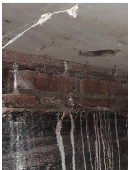
Figuur 91: Buitengevel van een woningblok vanuit de kruipruimte. Er is geen loodslabbe zichtbaar.
