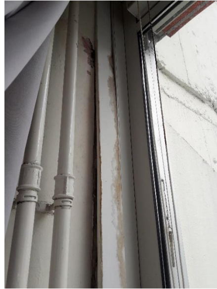
Figuur 5: Afdeklat voor het kozijn in de zuidoostgevel en de kopgevel, die krom trekt.
