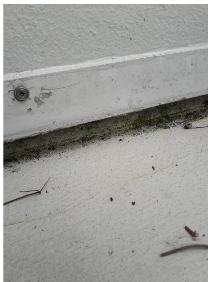
Figuur 24: Overgang tussen het prefab balkon en de balkonafdeling of kopgevel. Onderaan is zichtbaar dat de opstaande rand van het balkon smaller is dan de betonnen wand erboven. Op de overgang is een afdichtingsstrip aangebracht.
