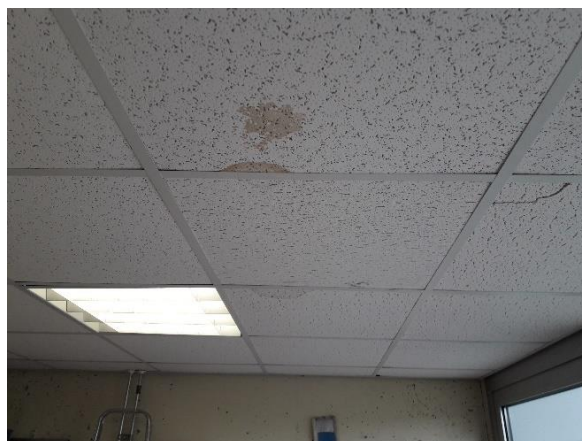
Figuur 9: Oude vochtplekken op het plafond van de begane grond, onder de kozijnen van de galerij.
