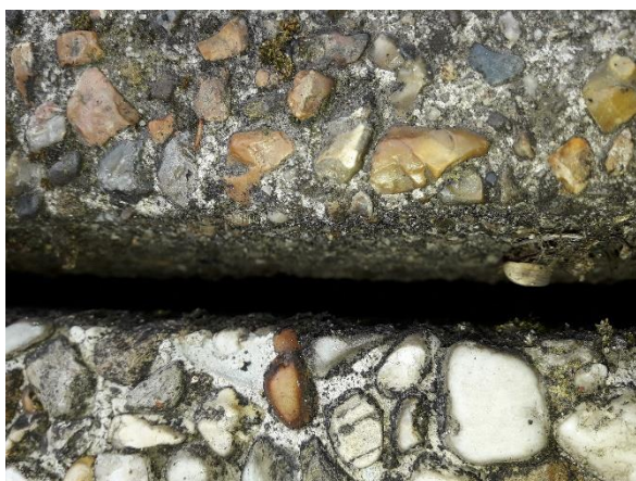
Figuur 66: Er zijn openingen tussen de grindtegels waardoor het water naar de kruipruimte kan lopen.
