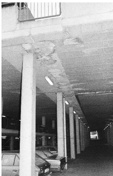
Figuur 69: Entree tot de parkeergarage aan de Vossenstraat in 1983 voordat de wijzigingen aan deze zijde van het gebouw zijn aangebracht. Er zijn vochtplekken aan de onderzijde van het beton zichtbaar.
