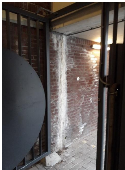
Figuur 52: Aanhoudende lekkages veroorzaken kalkuitslag op de muur bij de trap aan de Vossenstraat en de toegang naar de parkeergarage.
