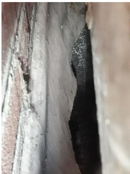
Figuur 98: Loodervanger van de woning is zichtbaar in de kruipruimte aan de straatzijde ter hoogte van de grindtegels.
