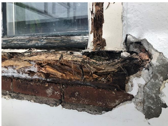
Figuur 123: Houtrot in de kozijnenstijl en dorpel door ingekapseld vocht.
