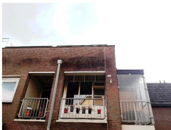
Figuur 97: Buitenzijde van het dakterras. Groei van organisch materiaal doordat de muur nat wordt door gescheurde waterkeringen.
