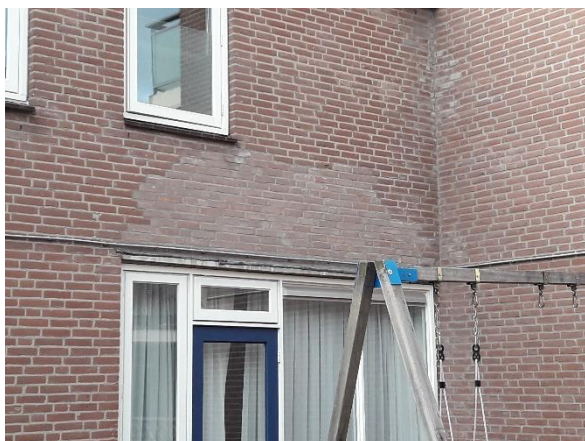
Figuur 102: Lood of loodervanger boven het kozijn is achteraf aangebracht. Het metselwerk erboven is verwijderd en opnieuw opgemetseld.
