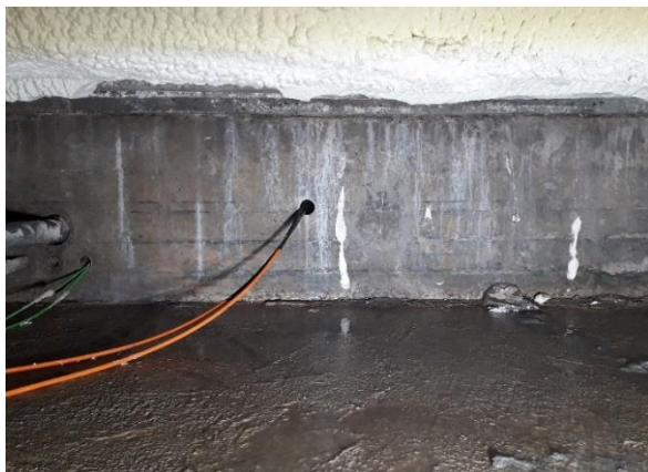
Figuur 56: De kruipruimte onder de woningen is vochtig. Er is zicht op de ringbalk die de woning draagt. De vloer en balk zijn nat. De lichte lijnen zijn kalkuitslag. Er is ook wit/gele na-isolatie aangebracht. Hier wordt niet naar verwezen.
