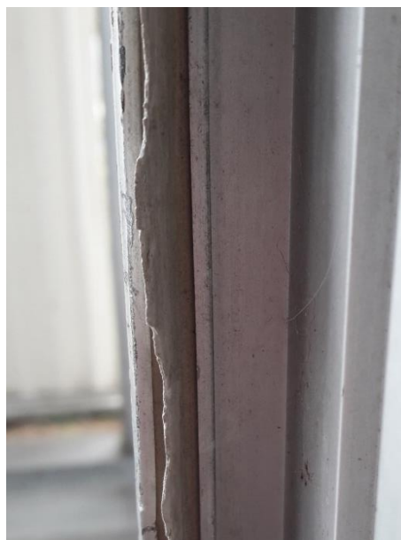
Figuur 31: Detailfoto van de aluminium kozijnen in de noordgevel. De rubberen tocht dichting brokkelt af.
