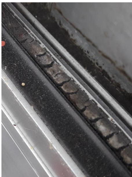
Figuur 30: Detailfoto van de aluminium kozijnen in de noordgevel. De kitnaden zijn bros.
