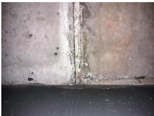
Figuur 8: Onderzijde van de galerij en woning. Het linker grijze vlak toont het prefab betonnen balkon, terwijl het rechter vlak de vloer van de woning weergeeft. De betonnen vlakken worden onderbroken door een houten lat. Op de muur is witte aanslag zichtbaar, en de lijnen die door water zijn veroorzaakt zijn duidelijk te zien (onderzijde van de foto).
