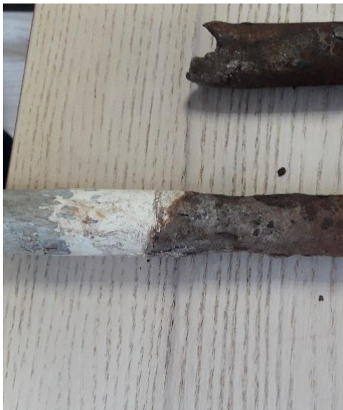
Figuur 6: Oude, doorgeroeste cv-leidingen die door de woningvloer gingen.
