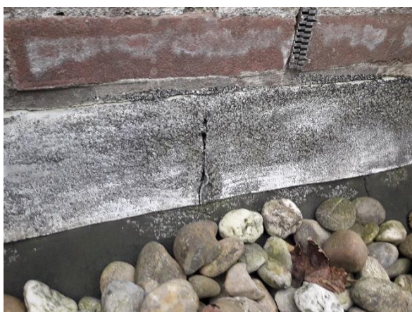
Figuur 96: Binnenzijde van de dakterrasborstwering met waterkering. De staat van het materiaal is onvoldoende om water te keren.
