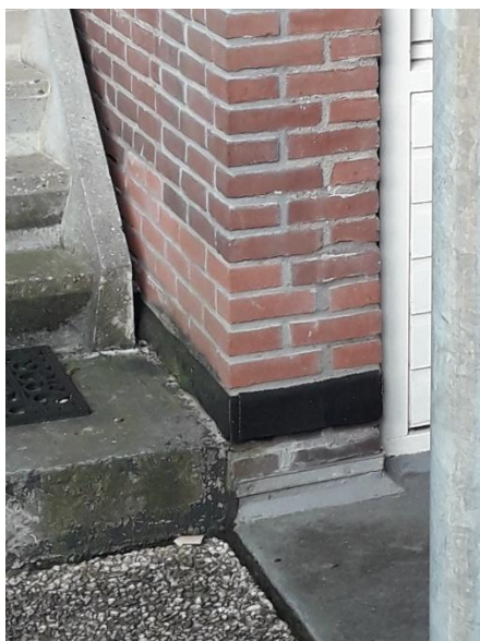
Figuur 100: Loodervanger boven het straatniveau en trapbordes is achteraf vervangen. Het metselwerk erboven is verwijderd en opnieuw opgemetseld.
