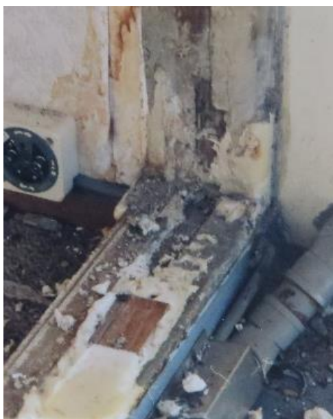
Figuur 29: Deel van de foto van de verwijdering van de kozijnen in de zuidgevel (1992). De houten lat tussen de balkonvloer en de binnenvloer is zichtbaar. Er is PUR-schuim toegepast. Op de binnenmuur zijn sporen van waterinfiltratie zichtbaar.
