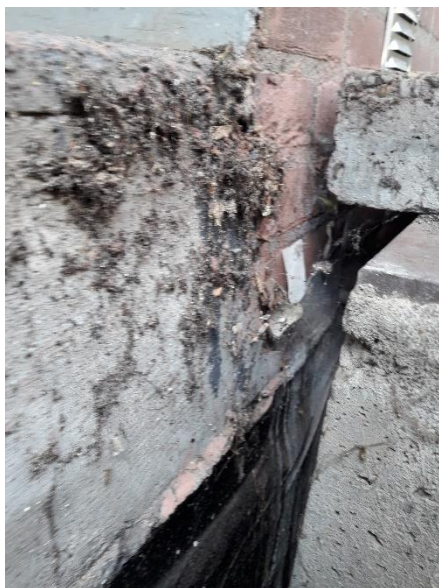
Figuur 116: Na het verwijderen van een grindtegel is zichtbaar dat vuil tussen de tegel door naar de kruipruimte onder de straat kan lopen.
